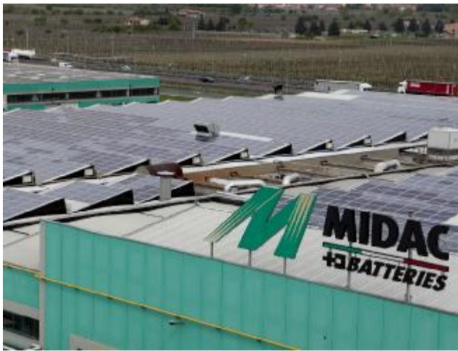
L'impianto fotovoltaico sul tetto della sede della Midac a Soave
